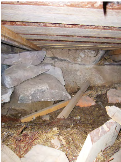
Kuva 52. Ryömintätila vaikuttaa kuivalta, mutta on täynnä vanhoja rakennustarvikkeita.
