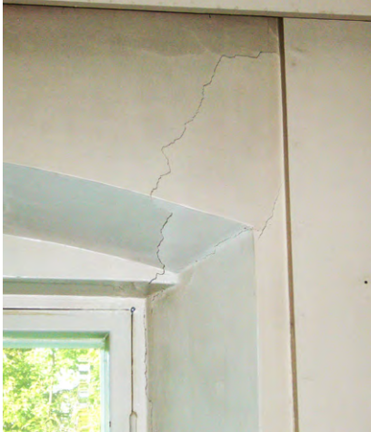
Kuva 50. vasemmalla ja 51. oikealla Sokkelista löytyy vain muutama tuuletusaukko. Osa luukuista on ilmeisesti suljettu 1970-luvun korjauksen yhteydessä. Sadevedet valuvat suoraan perustuksiin, joka on aiheuttanut perustusten liikkumista. Halkeama pohjoisjulkisivussa kuvattuna sisä- ja ulkopuolelta.
