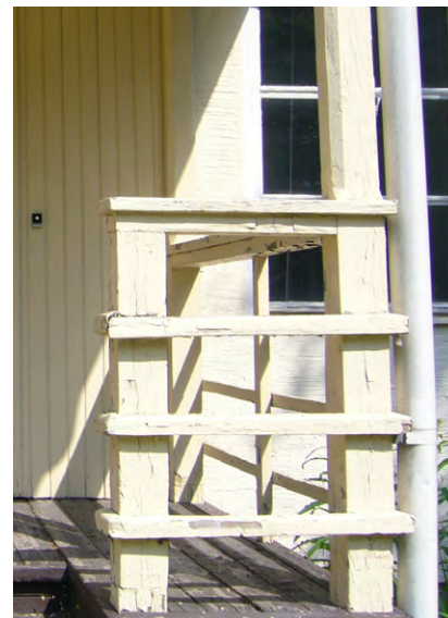
Kuva 69. Kuistien maalipinnat ovat kuluneet ja lohkeilleet.
