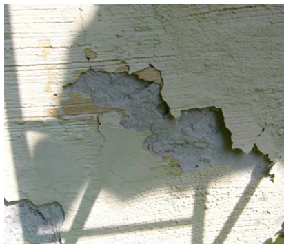
Kuva 61. Julkisivussa pieniä rappausvaurioita on useassa kohdassa, mm. kattotikasten kiinnityskohdan alla. Rappauksen alta pilkottaa Toja-levyä, jota on käytetty 1930-1950-luvuilla lisälämmöneristeenä.
