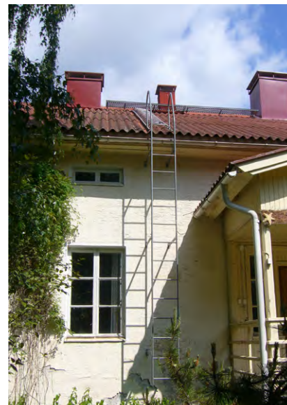
Kuva 68. Vesikatto varusteineen on uusittu 1970-luvulla.
