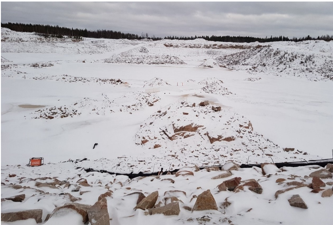
Kuva 2. Pumppu sekä purkuputki, joka johtaa veden ylös louhoksesta. (Kuva: H. Luusua)
