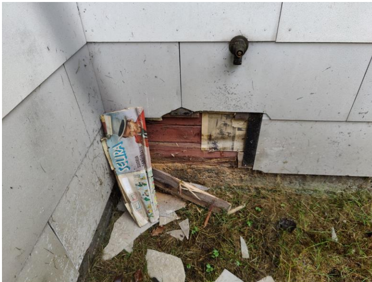
Kuva 3. Ulkoseinäavaus, vesipisteen alapuolella hirsissä on tuholaisten tekemiä vaurioita ja lahoa.
