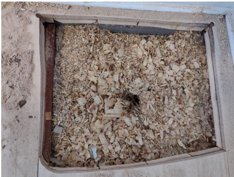
Kuva 8. Rakenneavaus keittiö, rotan tekemä tunneli eristeissä
