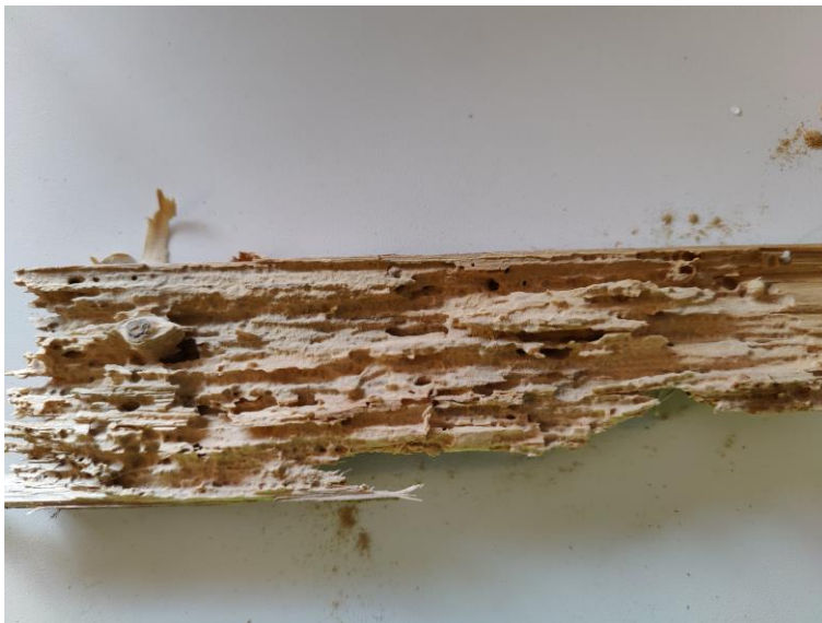
Kuva 5. Puutuholaisten aiheuttamia vaurioita hirressä
