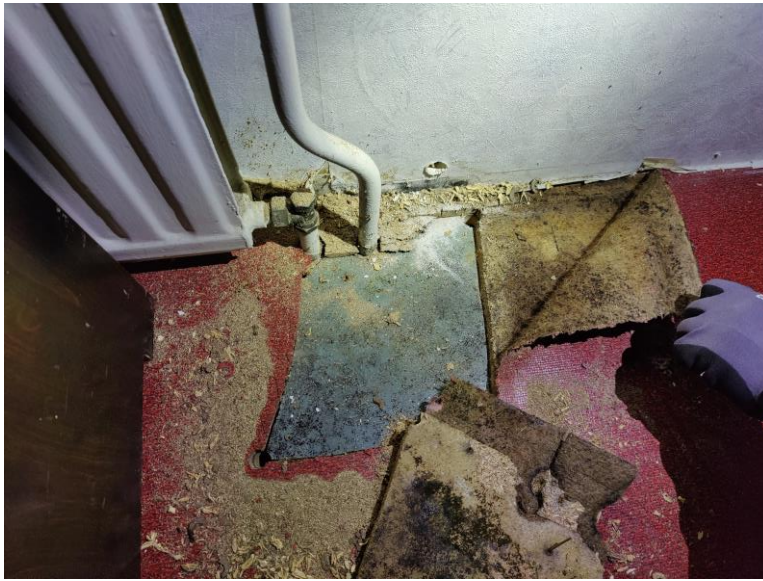
Kuva 7. Näkyvää kasvustoa lattia ja seinä rakenteessa
