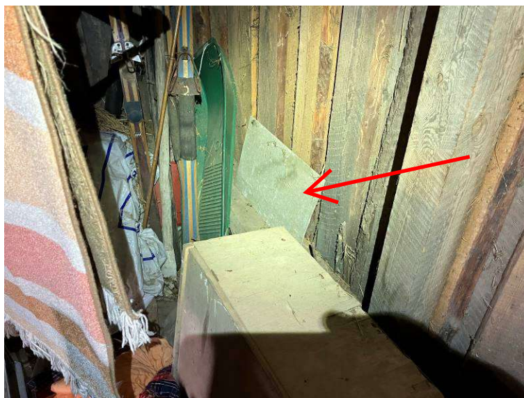
Kuva 2. Irrallinen asbestisementtilevy piharakennuksen varastossa
