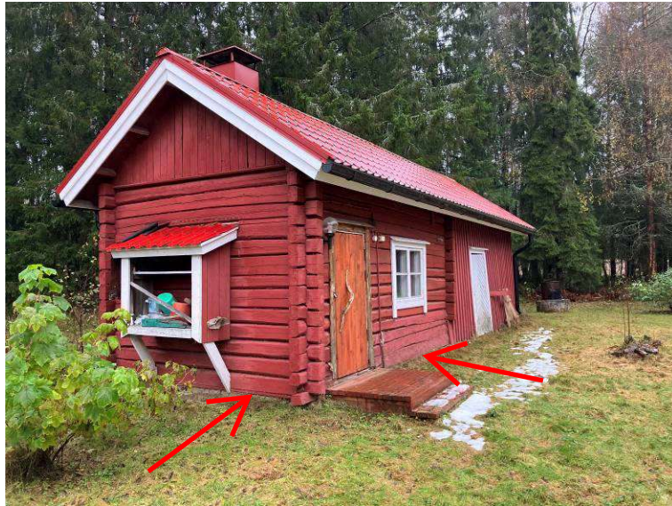
Kuva 11. Saunarakennuksen sokkelin päällä on PAH-yhdisteitä sisältävä bitumihuopa
