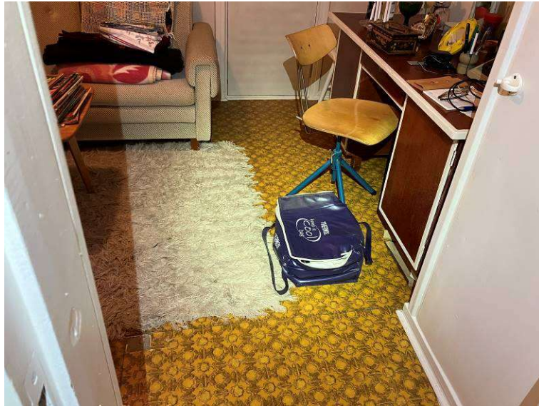
Kuva 3. Asbestia sisältävä matto toisen kerroksen makuuhuoneessa
