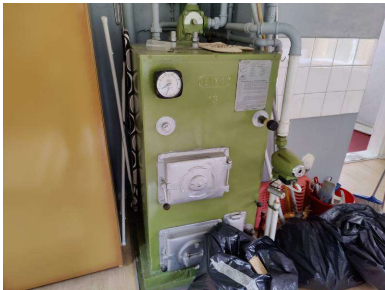
Kuva 8. Kattilassa voi olla asbestieristyksiä
