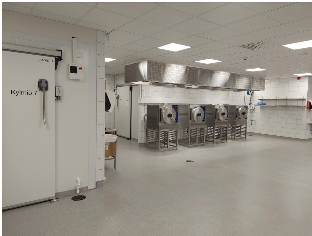
Kuva 6. Keittiön kylmiö ja laitteita
