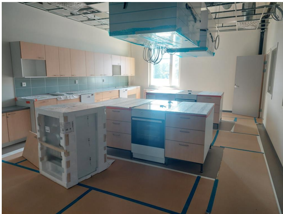
Kuva 8. 3.krs B-lohkolla kotitalousluokissa kodinkoneita asennettu.
