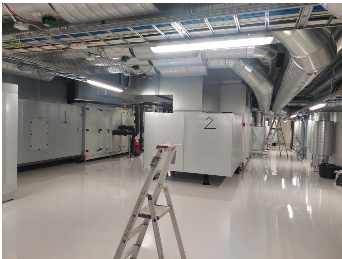
Kuva 8. 2.krs ilmanvaihtokonehuone siivottu ja puhtaustarkastettu.
